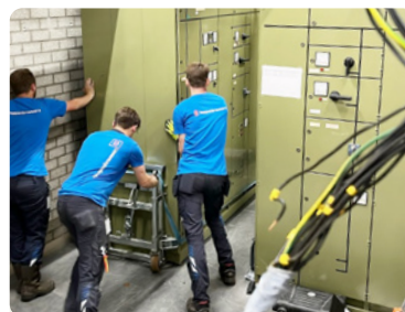
Bij rioolwaterzuivering Dokhaven op Rotterdam-Zuid zijn dit jaar schakelkasten vervangen. Hierdoor wordt jaarlijks zo'n 300.000 kWh bespaard! Dit komt overeen met 122 ton CO 2 !
