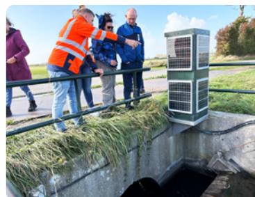
Een stuw op zonne-energie op Goeree. Er zijn tientallen van dit soort stuwen in ons beheersgebied. Dit exemplaar staat aan de Plasdijk in de polder Oud Westerloo.
